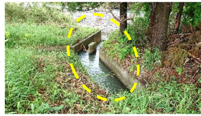
農業用水路整備：台風19号被害
