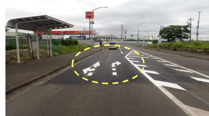
道路陥没整備 安全対策
